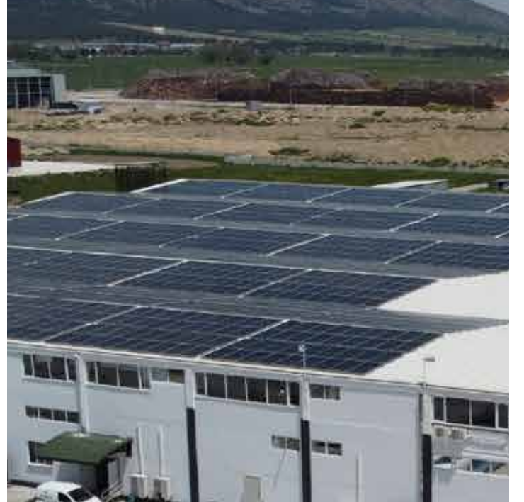
FİLTORQ-FİLTOR 1.2MWp ÇATI - DENİZLİ
