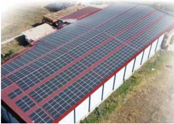
BULUT SOĞUKHAVA 360KWp ÇATI - DENİZLİ
