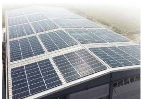
SEMİH HACİM 400KWp ÇATI - DENİZLİ
